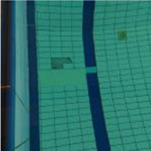
Fliser løsnet bassengbunn høsten 2022
