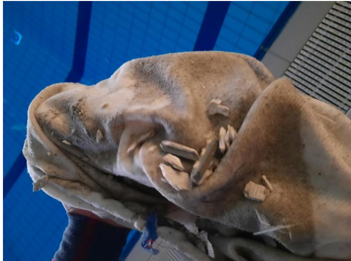
Fliserester, fuger, betong- partikler fra basseng 23.01.2023
