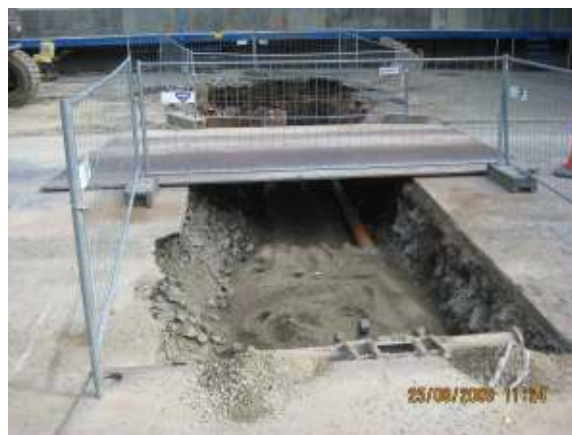
Kjøreplate er ikke frest ned i dekket
