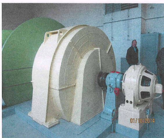
Bilde 9 Dagens generator
