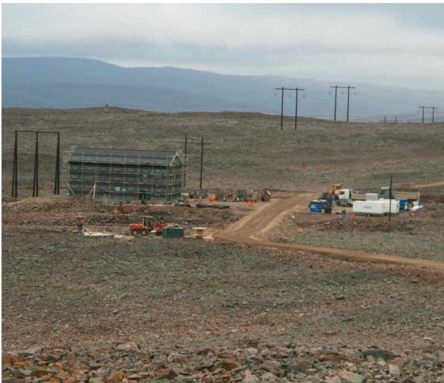
TRAFØ: Inne på fjellet er det bygd trafostasjon og en ny kraftlinje til stasjonen.
