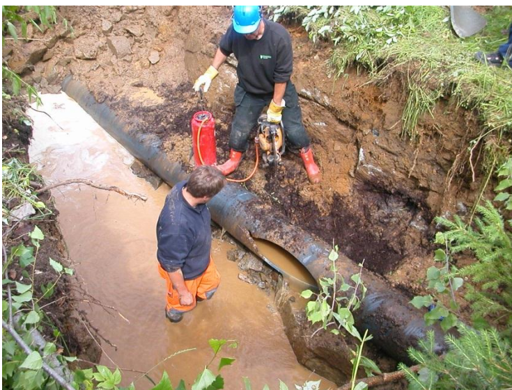
Figur 1.3.2 Brudd på hovedvannledning ved Kjølssetsvea i 2009.
